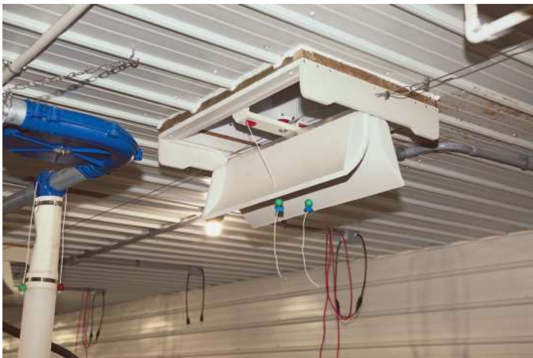
Рисунок 3 – Потолочные приточные воздуховоды
